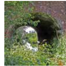
Bestehende Überführungen und Durchlässe von Gewässern werden aufgeweitet und mit Trockenbermen für die Tierwanderung kombiniert.
