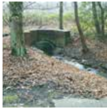
Durch den Einbau von Eisenbahnüberführungen sollen Bäche, die heute im Bereich der Bahnstrecke verrohrt sind, zukünftig offengelegt werden.
