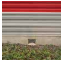
Kleinsäuger und Reptilien können durch kleine Öffnungen in den Sockeln der Schallschutzwände wandern.
