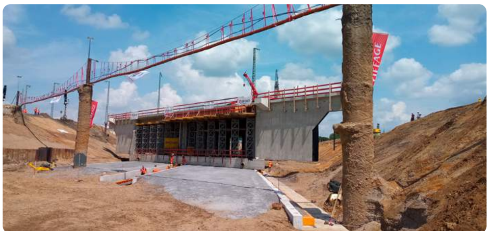
40 Meter lang, 23 Meter breit und 10.000 Tonnen schwer: Das neue Brückenbauwerk in Wesel
